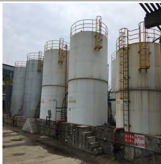
液体原料储罐区
