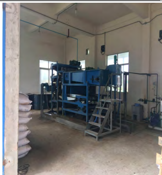
污泥干燥设施
