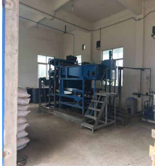
污泥干燥设施
